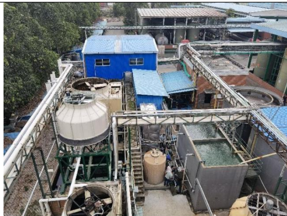
综合废水处理设施
