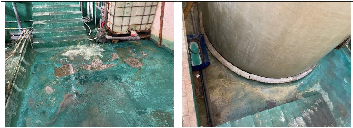
储罐一区及仓库
