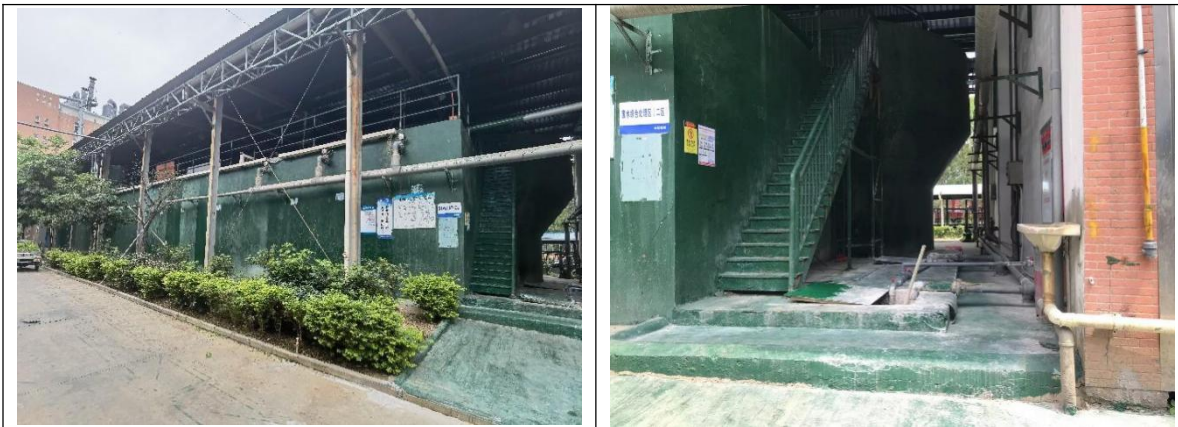
生化废水处理设施
