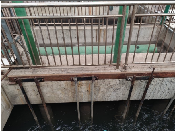
厂区污水处理站进一步处理（调节池）
