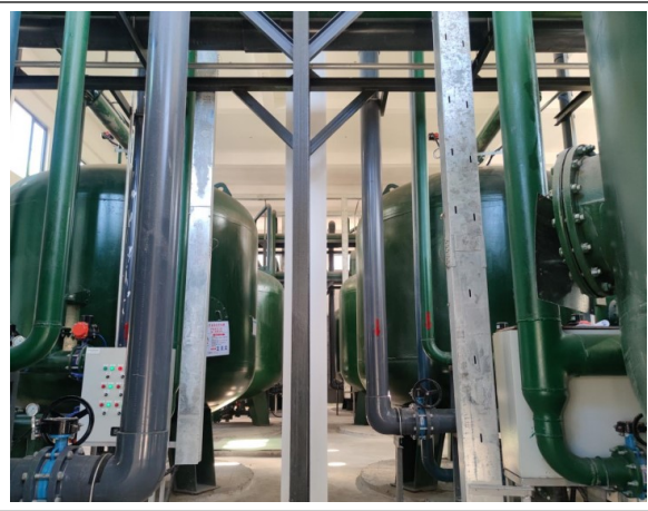
厂区污水处理站进一步处理（多介质过滤器）
