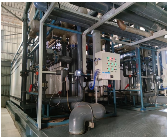
厂区污水处理站进一步处理（超滤）
