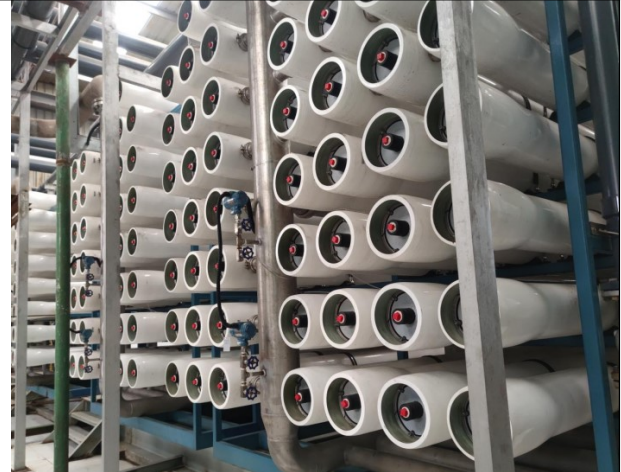
厂区污水处理站进一步处理（反渗透）
