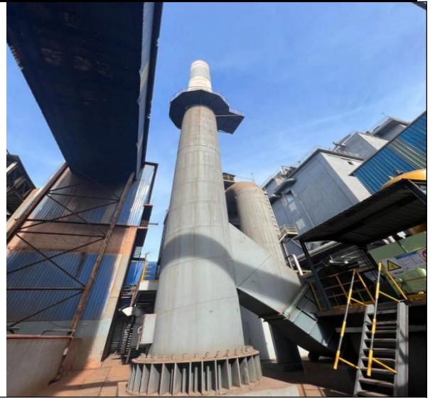
石灰窑成品除尘排气筒及采样平台
