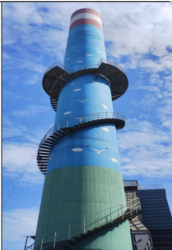
脱磷炉岗位除尘烟囱、采样平台
