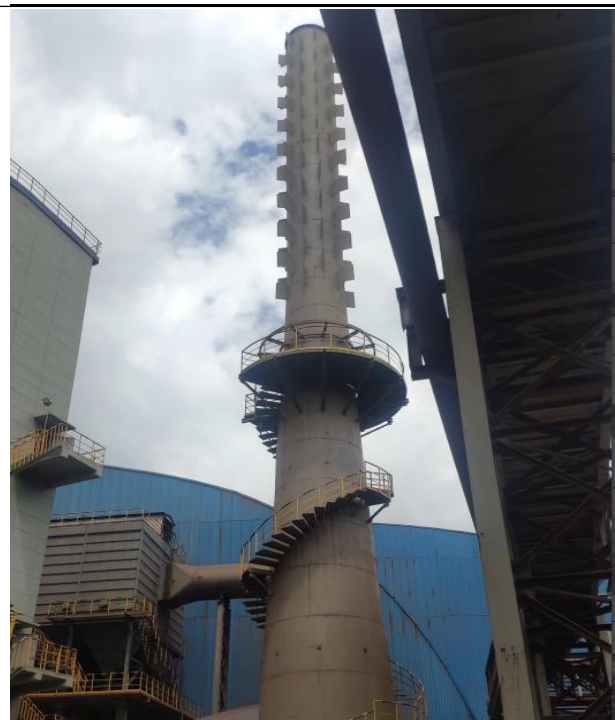
烧结机燃料破碎除尘烟囱、采样平台
