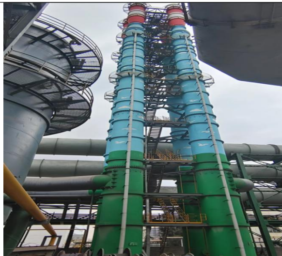
脱磷炉烟气除尘烟囱、采样平台
