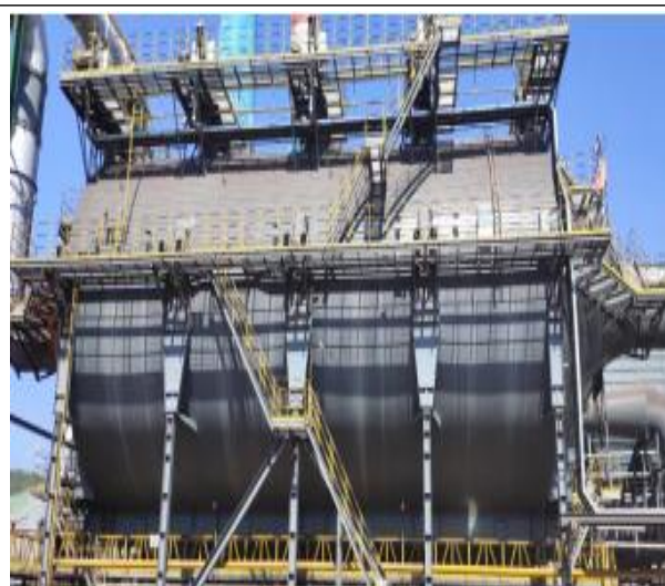
脱磷炉烟气除尘系统
