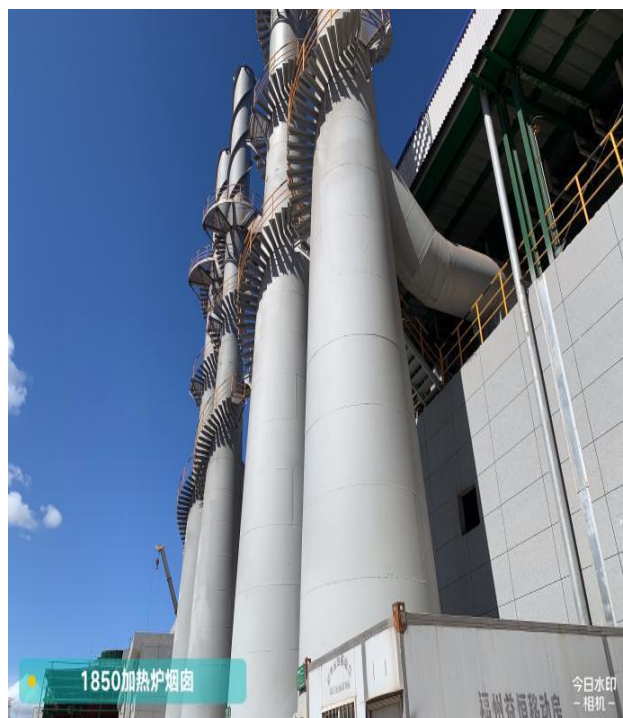
1850热轧加热炉烟囱排放口、采样平台
