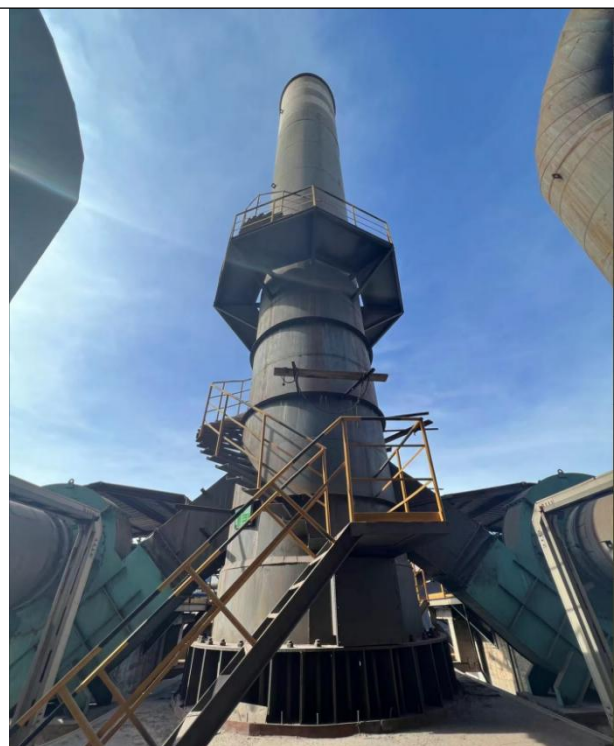
1#、2#麦尔兹窑窑体烟气排气筒及采样平台
