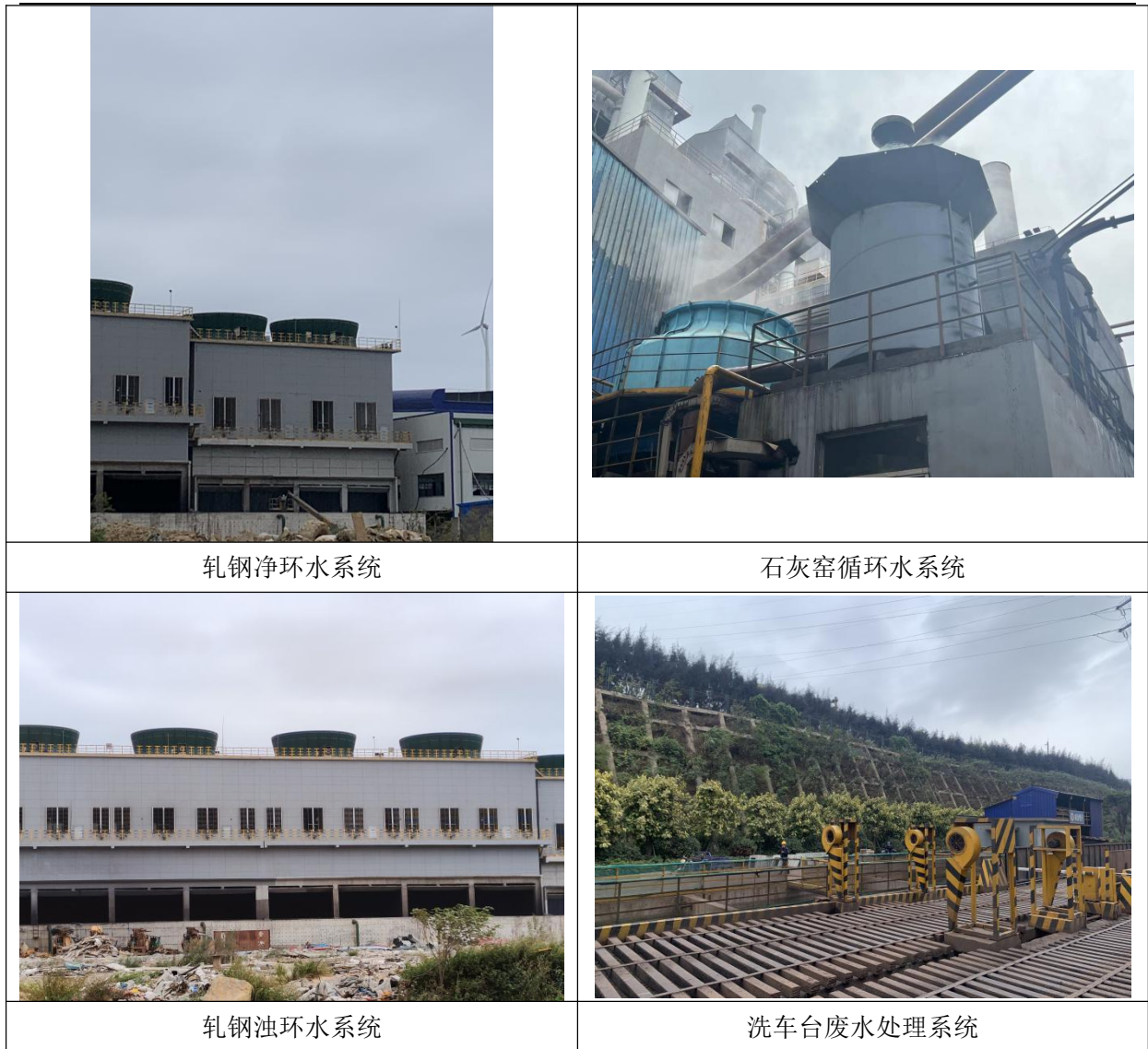
图 4.1-5 废水处理设施照片
