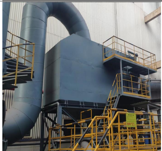
250m 2 烧结机白灰配料除尘系统
