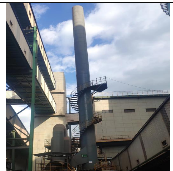
250m 2 一混除尘烟囱、采样平台
