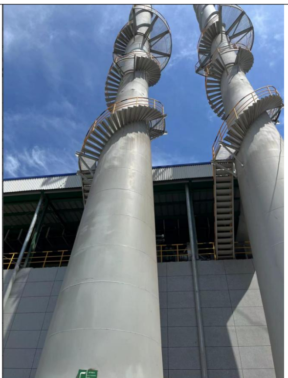
1850热轧加热炉烟囱排放口、采样平台
