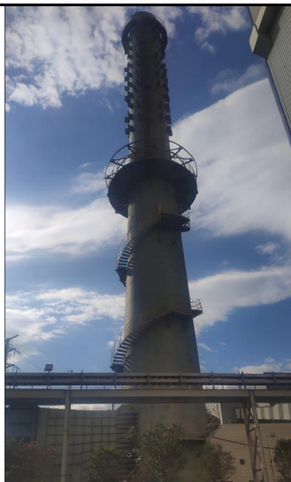
250m 2 烧结机机尾除尘烟囱、采样平台
