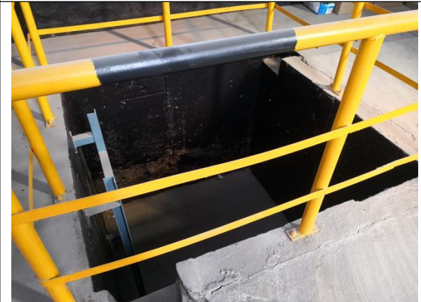
危废暂存间事故池
