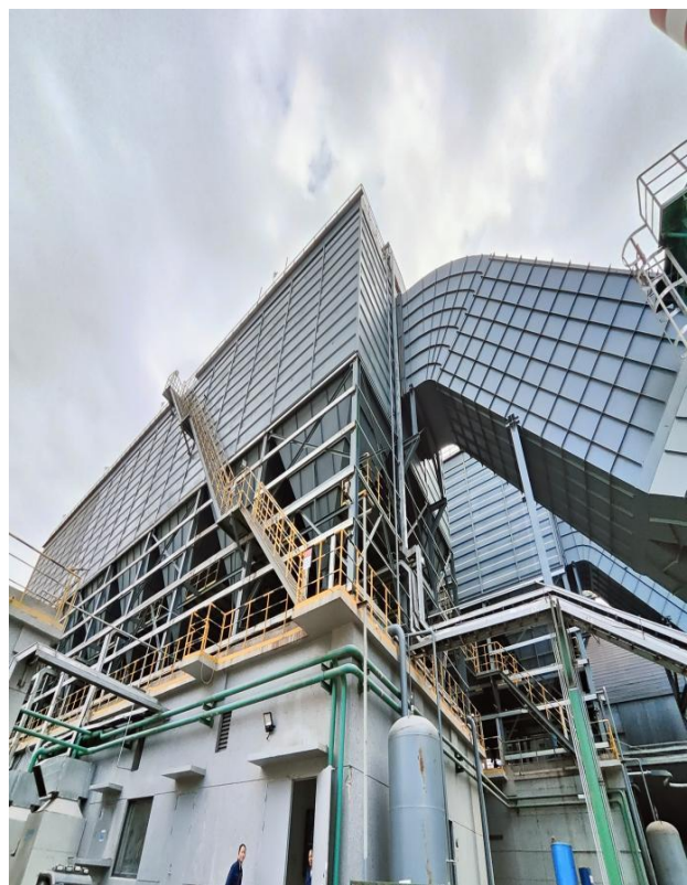
脱磷炉岗位除尘系统
