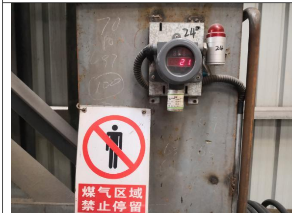
车间内煤气报警器
