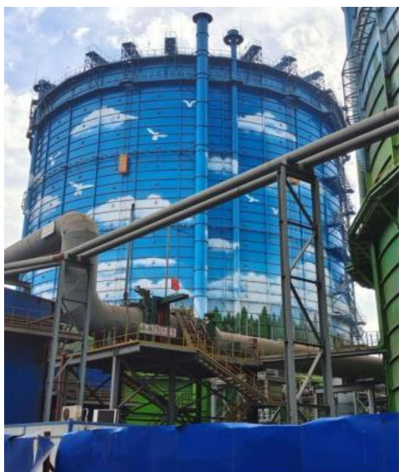
8 万 m 3 转炉煤气柜
