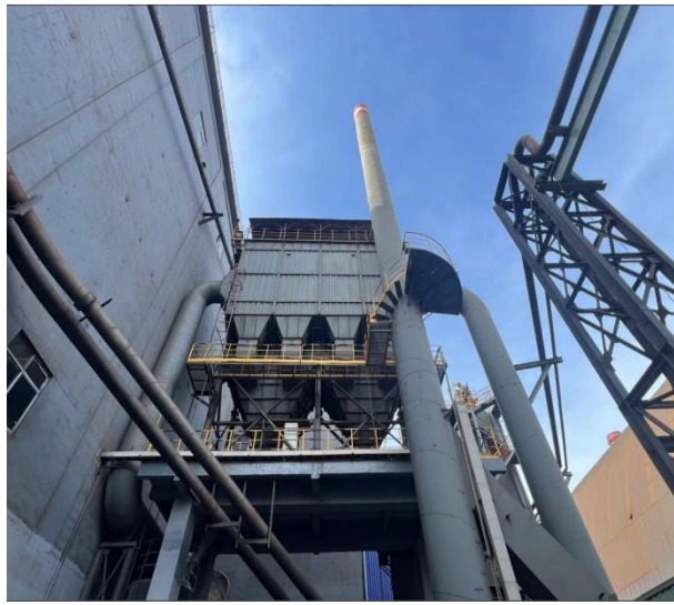
小渣破碎废气排气筒及采样平台
