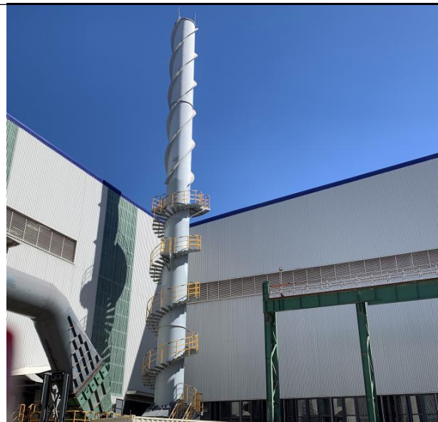
1850热轧粗轧排放口、采样平台
