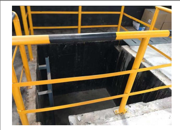
危废暂存库（事故收集池、围堰）
