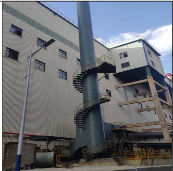
250m 2 烧结机白灰配料除尘烟囱、采样平台
