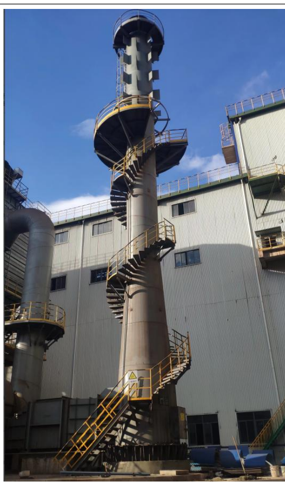
250m²烧结机成品矿槽除尘烟囱、采样平台
