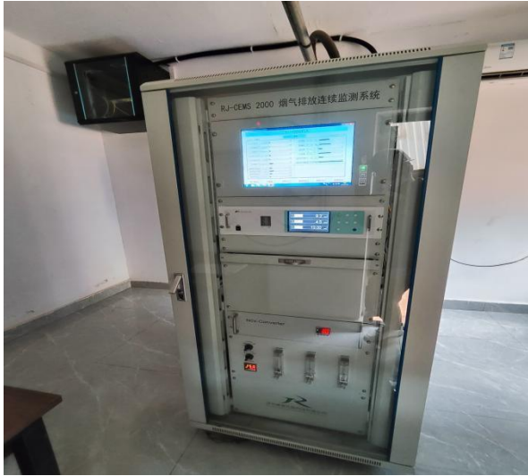
250m 2 烧结机机头烟气在线监测设施
