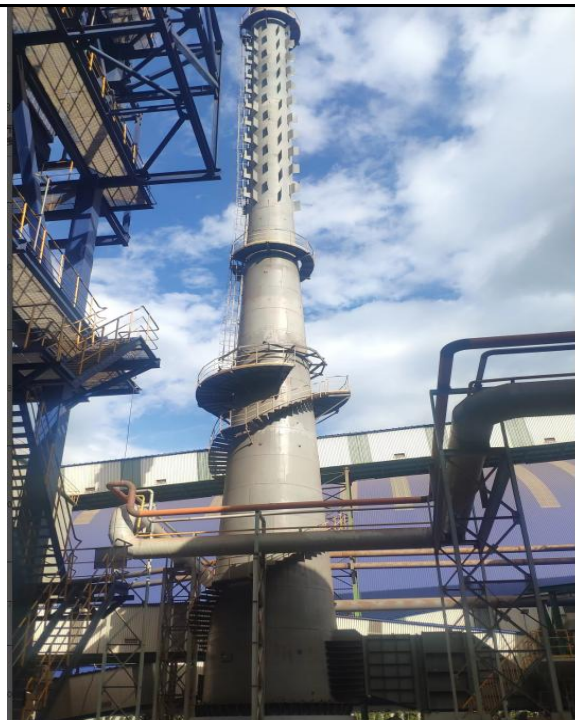
250m²烧结机配料室除尘烟囱、采样平台
