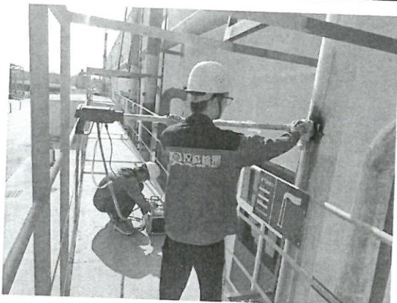
DA009 检测照片
