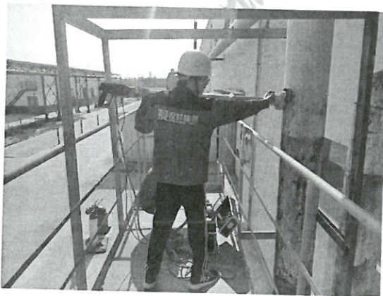
DA007 检测照片
