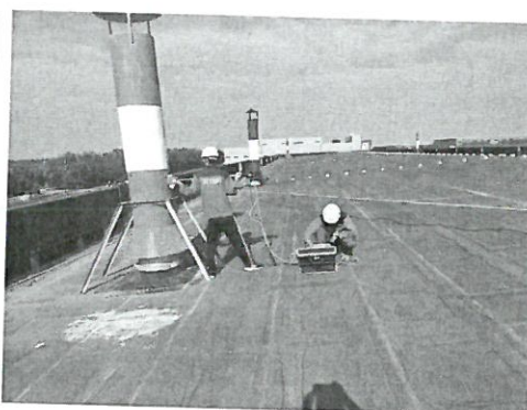
DA002 检测照片
