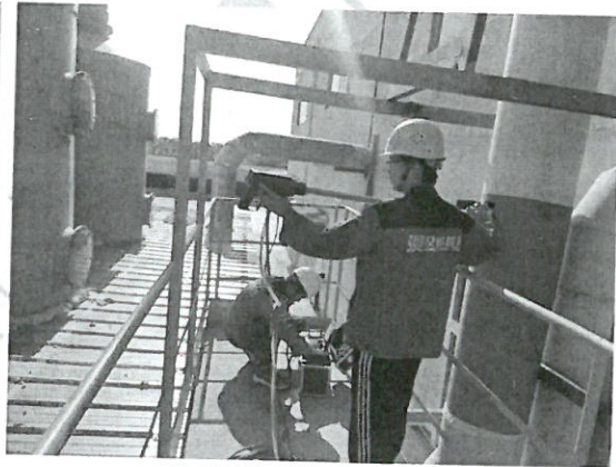
DA006 检测照片
