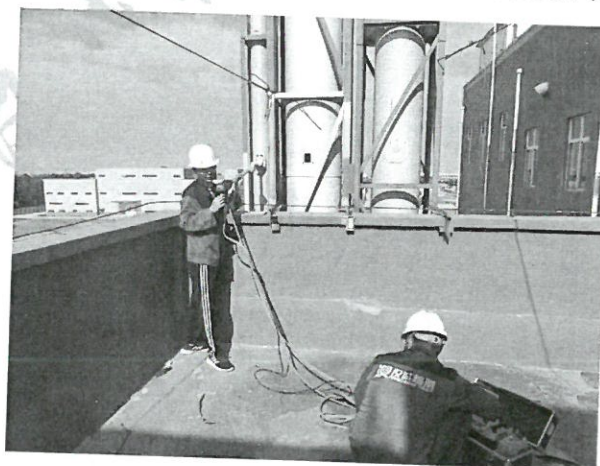
DA012 检测照片
