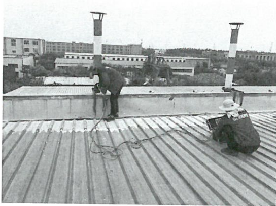
DA011 检测照片
