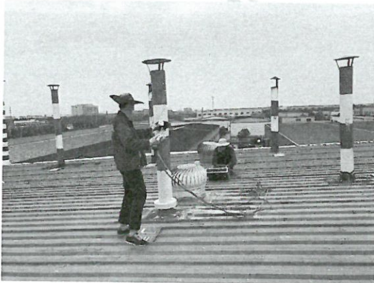
DA009 检测照片
