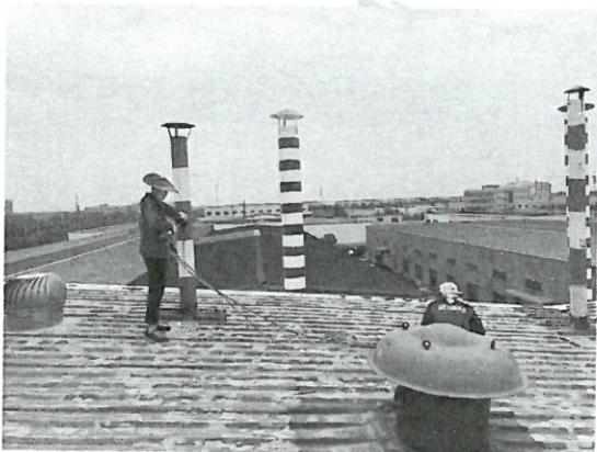
DA016 检测照片
