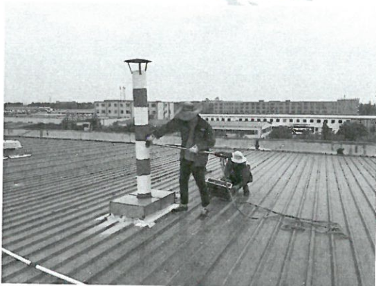
DA028 检测照片
