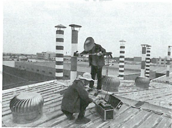
DA015 检测照片
