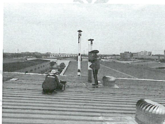
DA008 检测照片
