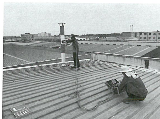
DA010 检测照片
