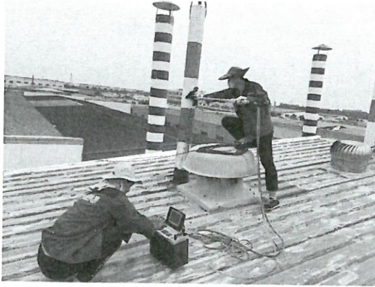
DA018 检测照片
