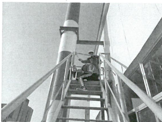
DA010 检测照片
