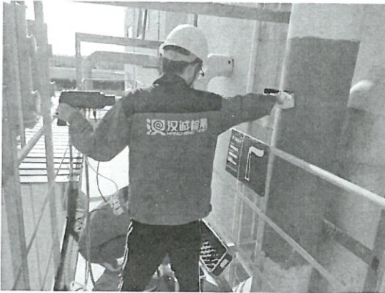
DA005 检测照片
