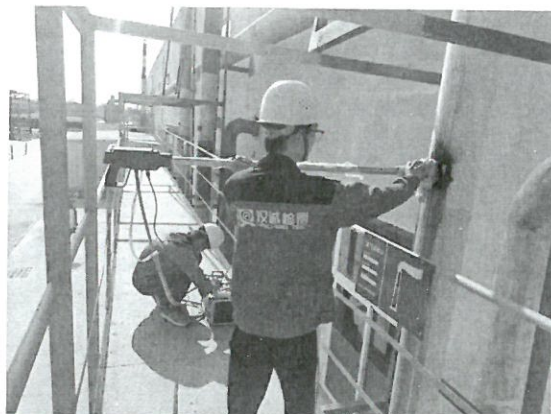
DA009 检测照片
