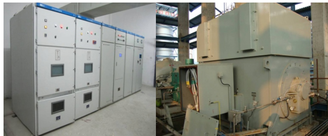
中国石油长岭分公司 280万吨/年催化裂化装置项目 软起动装置型号: ATA QB-H10/23000KW 负载: 压缩机 控制方式: 一拖二 Changling Branch of China 2,800,000 tons of oil / year catalytic cracking derive project Soft Starter Model: ATA QB-H10/23000KW Load :Compressor Control mode: One driven two
