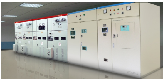
唐山建龙实业有限公司 高炉鼓风机系统 软起动装置型号: ATA QB-H06/11000 Tangshan Jianlong Industry Co.,Ltd. Blast furnace blower system Soft Starter Model:ATA QB-H06/11000
