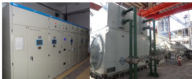
福建三安钢铁高炉项目 软起动装置型号: ATA QB-H10/19000 电机型号: YGF1000-4 (上海电机厂) 负载: 鼓风机 (陕鼓) Fujian Sanan Steel blast furnace Project Soft Starter Model: ATA QB-H10/19000 Motor Model: YGF1000-4 (Shanghai Electric Machinery Co.,Ltd.) Load: Blower (Shanxi Blower(Group) Co.,Ltd.)
