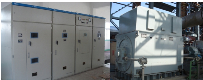
中国化工山东昌邑石化有限公司 烟气轮机能量回收机组主风机系统 软起动装置型号: ATA QB-H10/14000 负载: 压缩机 China national chernical corporation Changyi branch Main blower system in flue gas turbine energy recovery unit Soft Starter Model: ATA QB-H10/14000 Load:compressor
