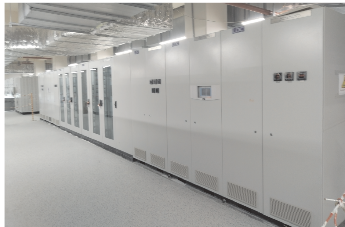
乌兹别克斯坦锡尔河1500MW 燃气联合循环独立电站工程——现场图
