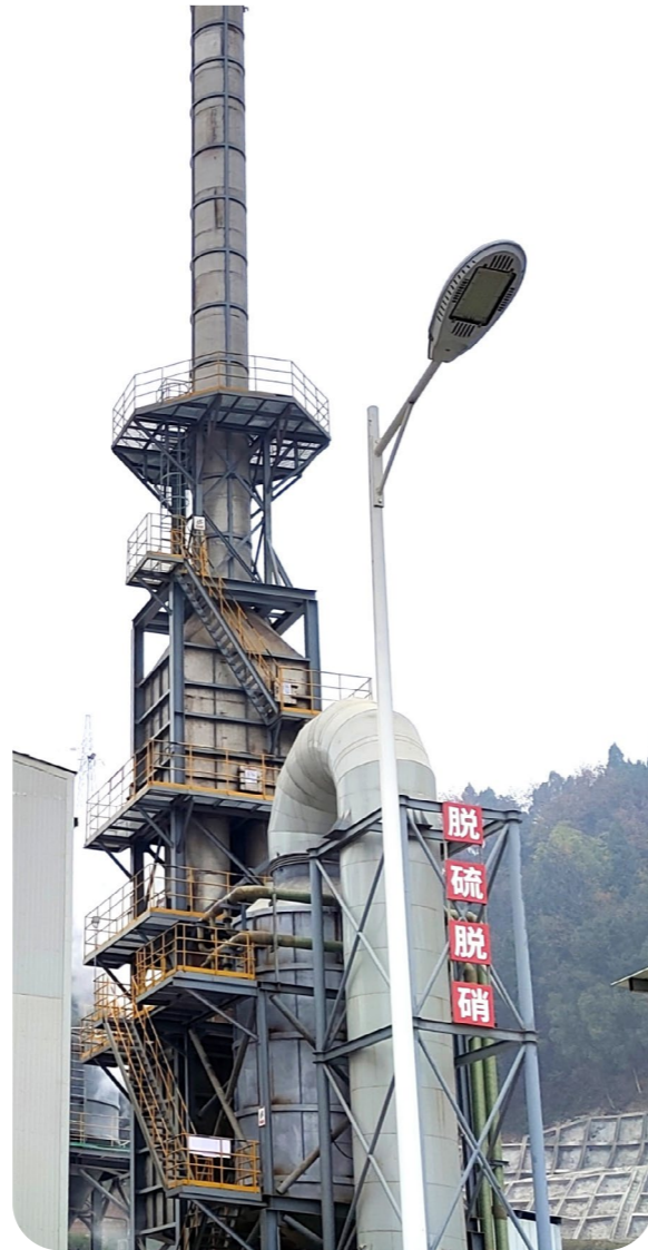
遂宁盛新脱硫脱硝设施
