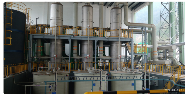
废气处理：电解产生的氯气通过管道输送至尾气吸收塔，通过吸收塔内碱液喷淋，将氯气中和，形成副产品次氯酸钠。吸收后的尾气通过烟囱达标排放
