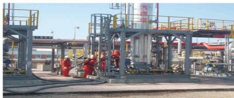
中石化普光净化厂、元坝净化厂检修清洗和除臭钝化工程
