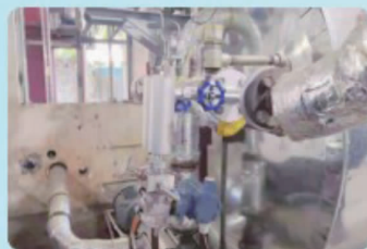
高温水应用现场
