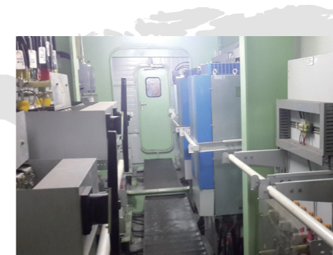
国内在用的最大吨位的起重机为380t铸造起重机，装置电压为690V。
