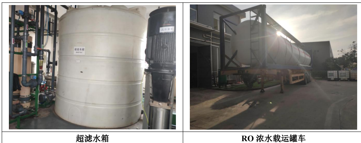
图 14 废水处理系统现场图（宙邦原一期项目污水处理站）
