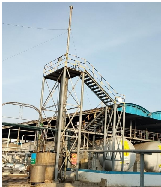
硝酸储罐及硝酸装车废气碱液喷淋装置
