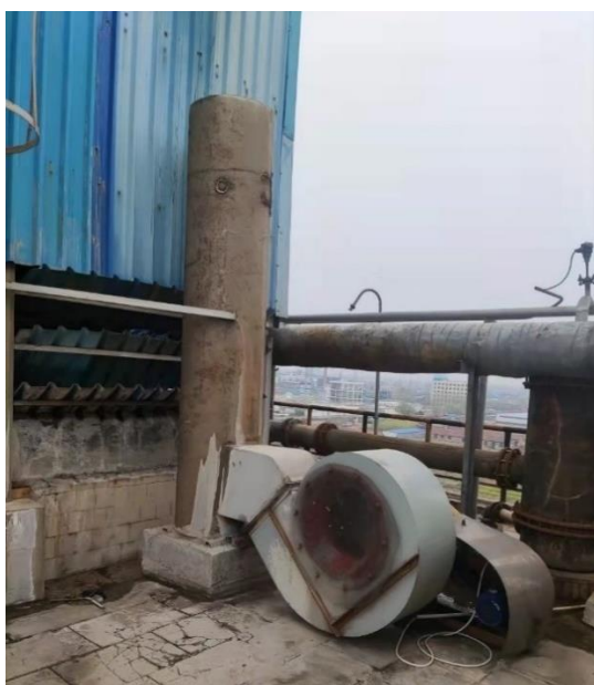
稀硝酸浓缩废气排气筒
