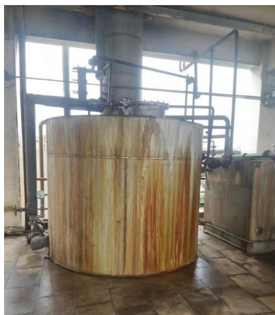
稀硝酸浓缩废气水喷淋装置
