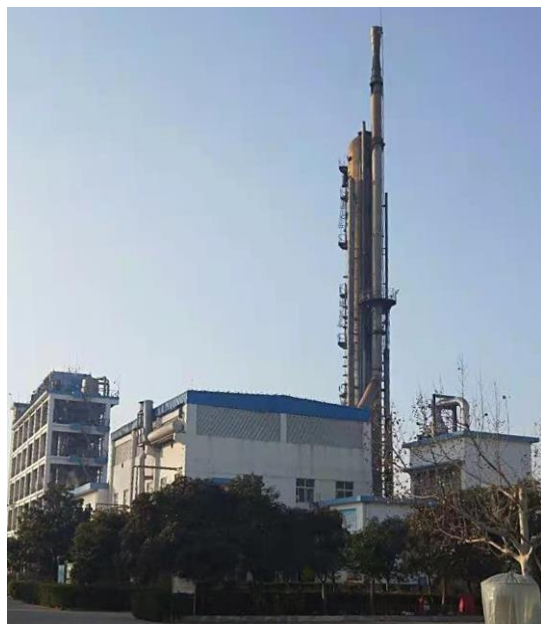
吸收塔尾气处理排放装置
