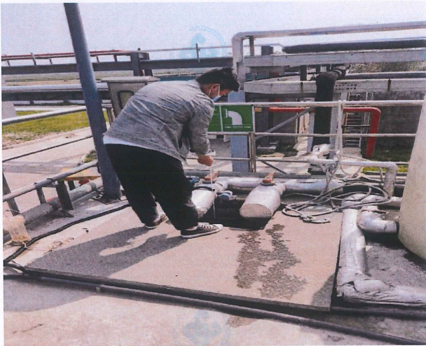
图 1: ★1#厂内污水处理站设备出口
