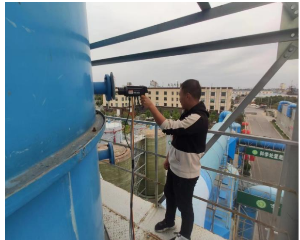
图 4: ●3# (1-3 号) 仓库、料坑综合处置车间废气排气筒
