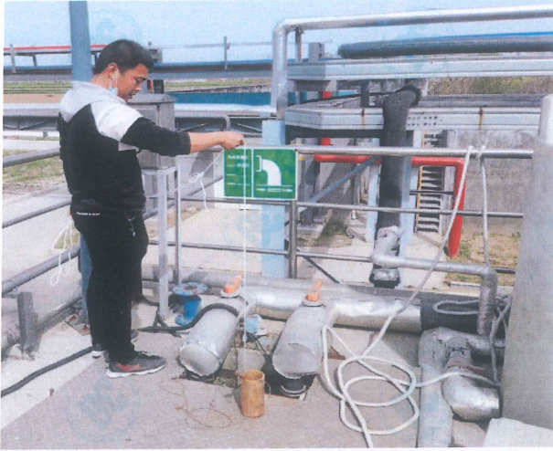
图 1: ★1#厂内污水处理站设备出口
