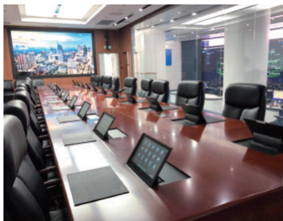
国债ECC数据中心
