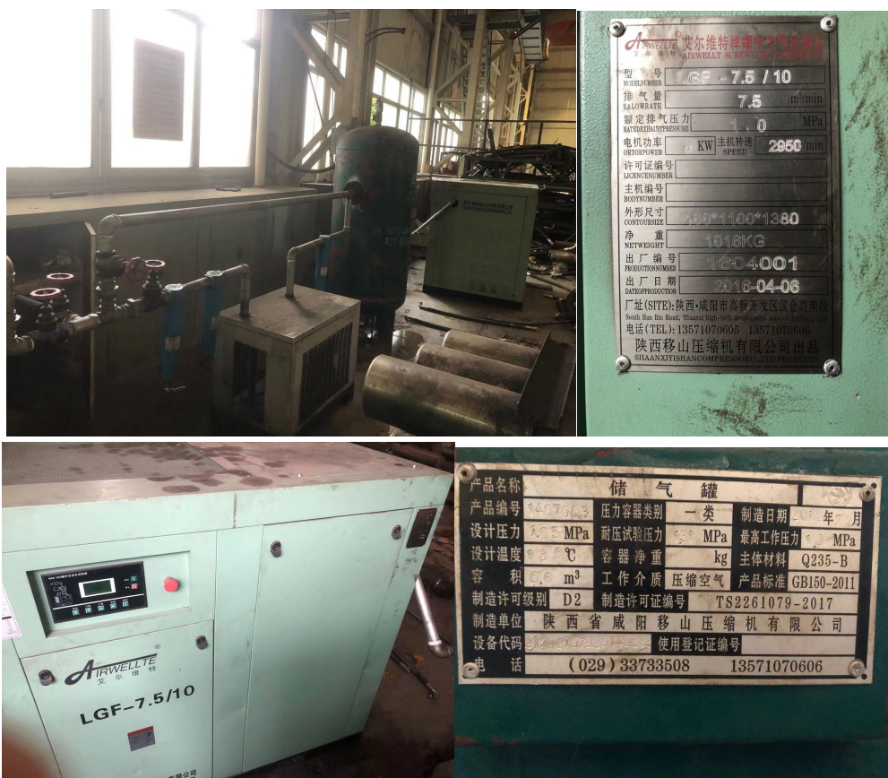
图 1-12 空压机现场照片
